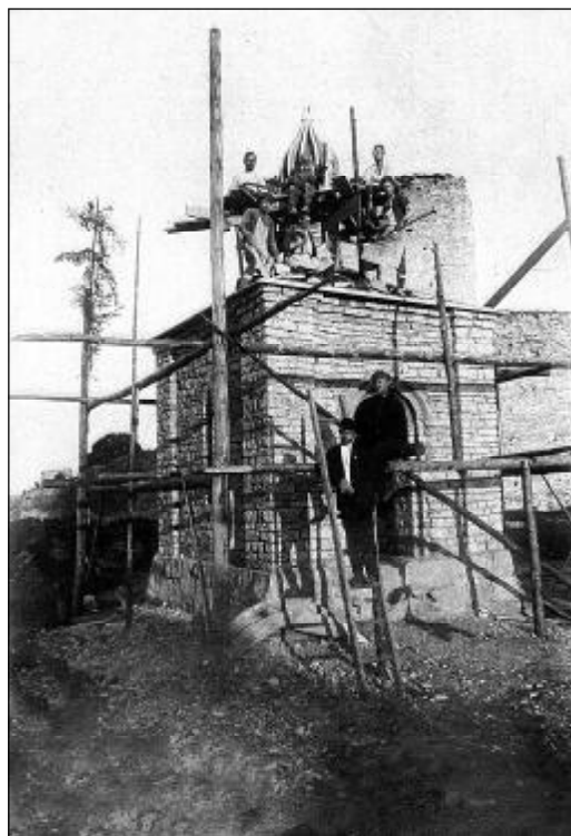
На строительстве часовни Корсунской Божией Матери в Старом Изборске. На переднем плане - Г.И. Копьев (слева), рядом - К.А. Костенко-Родзиевский. Конец 1920 гг.
